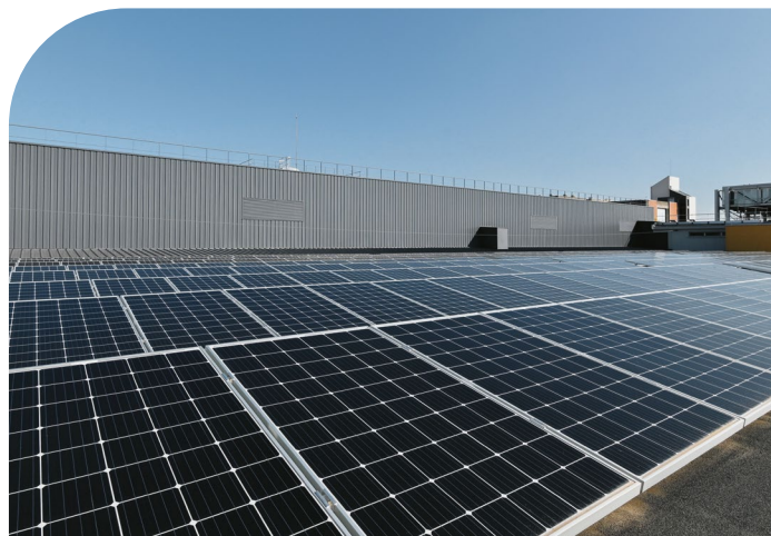
Les panneaux photovoltaïques de l'usine de Choisy-le-Roi
