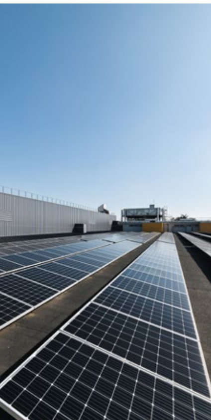
L'installation photovoltaïque de l'usine de Choisy-le-Roi.
